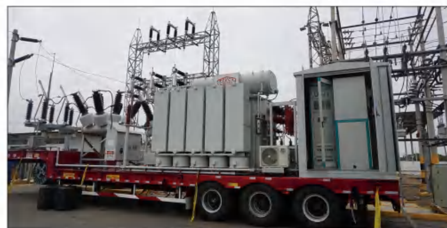
厄瓜多尔69kV移动式变电站
