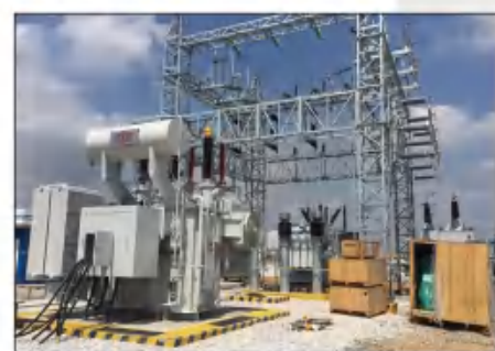
厄瓜多尔电站69kV 主变
