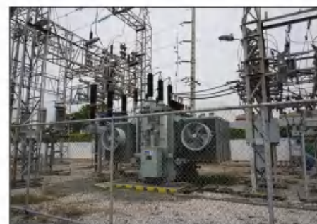
哈萨克斯坦变电站110kV主变
