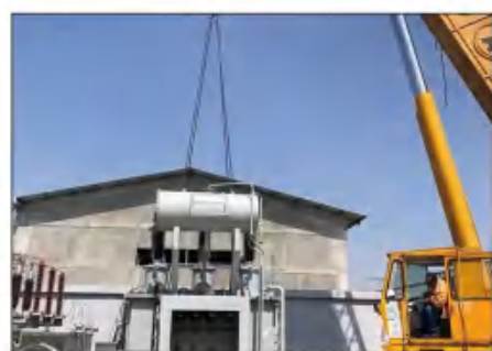
澳大利亚电站主变
